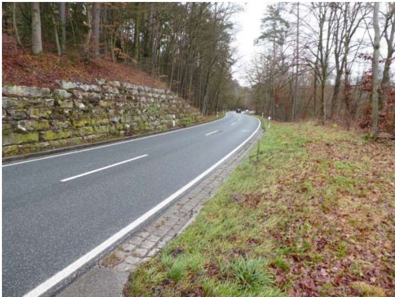
Böschungsbereich Staatsstraße 2402, Blick Richtung Fröschau
